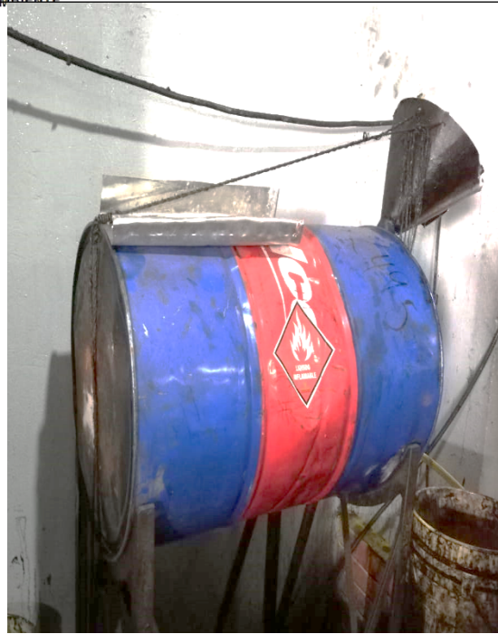
FOTOGRAFÍA No.2 ALMACENAMIENTO ACEITE USADO
